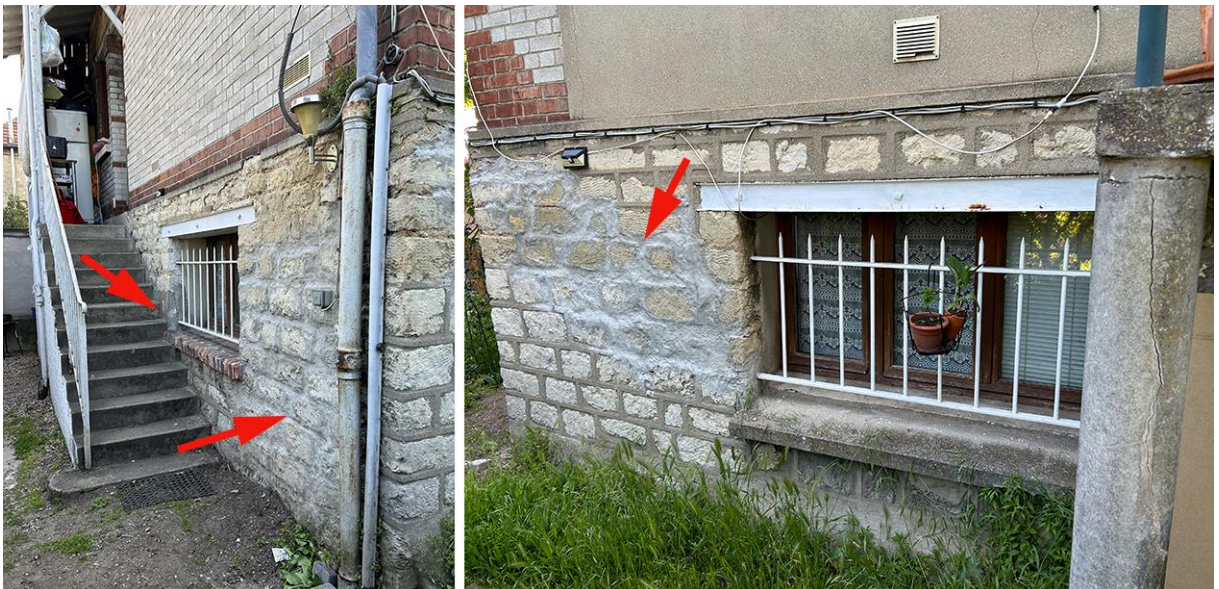
Murs a rejointoyer et jonction avec l'escalier à traiter
